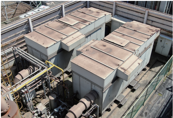
【コージェネ設置状況（既設）】
