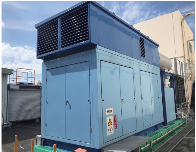
【コージェネ設置状況】
