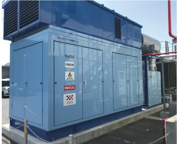
【コージェネ設置状況】
