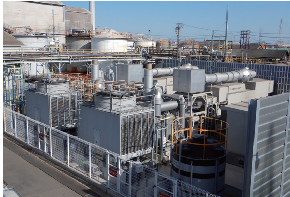
【コージェネ設置状況（新設）】
