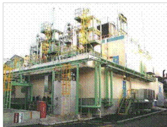
図-3 ガスエンジン棟*1)
