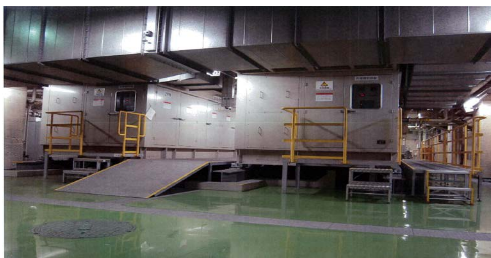
写真-1 コージェネレーション設備
