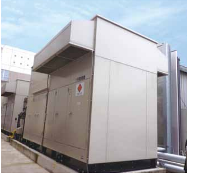
写真① 更新後のガスエンジンコージェネレーション
