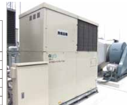
写真① ガスエンジン
