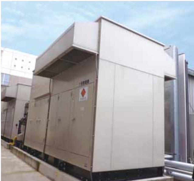
写真① 更新後のガスエンジンコージェネレーション
