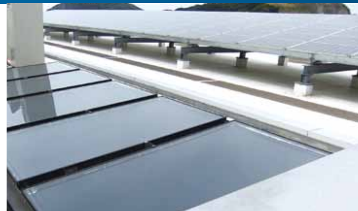
写真③ 太陽熱利用温水供給設備 (矢崎エナジーシステム(株))
