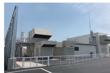
自己託送発電設備
