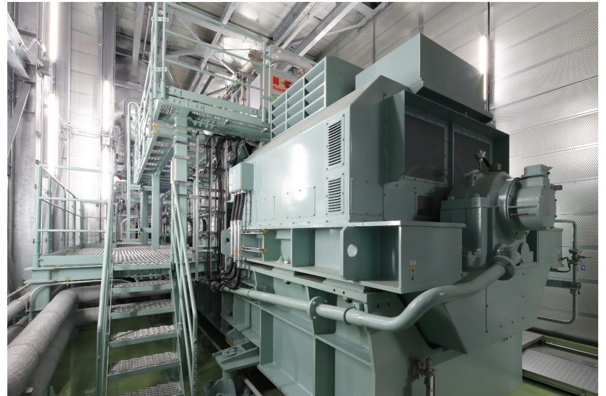
▲大型ガスエンジンCGS
