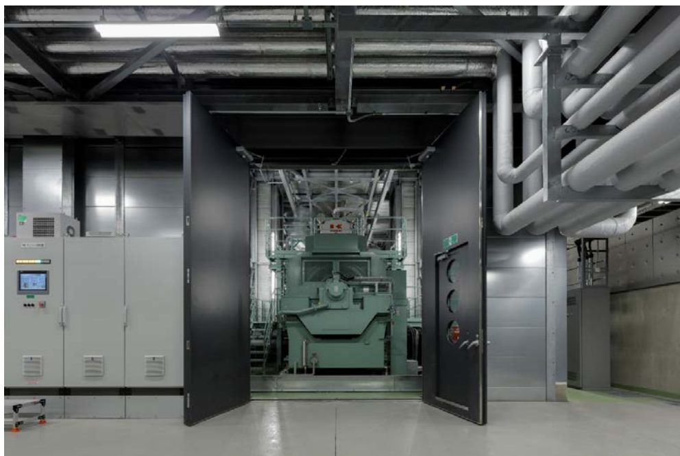
▲CGSエンクロージャー（扉開口時）
