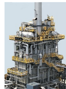
排熱回収ボイラ
