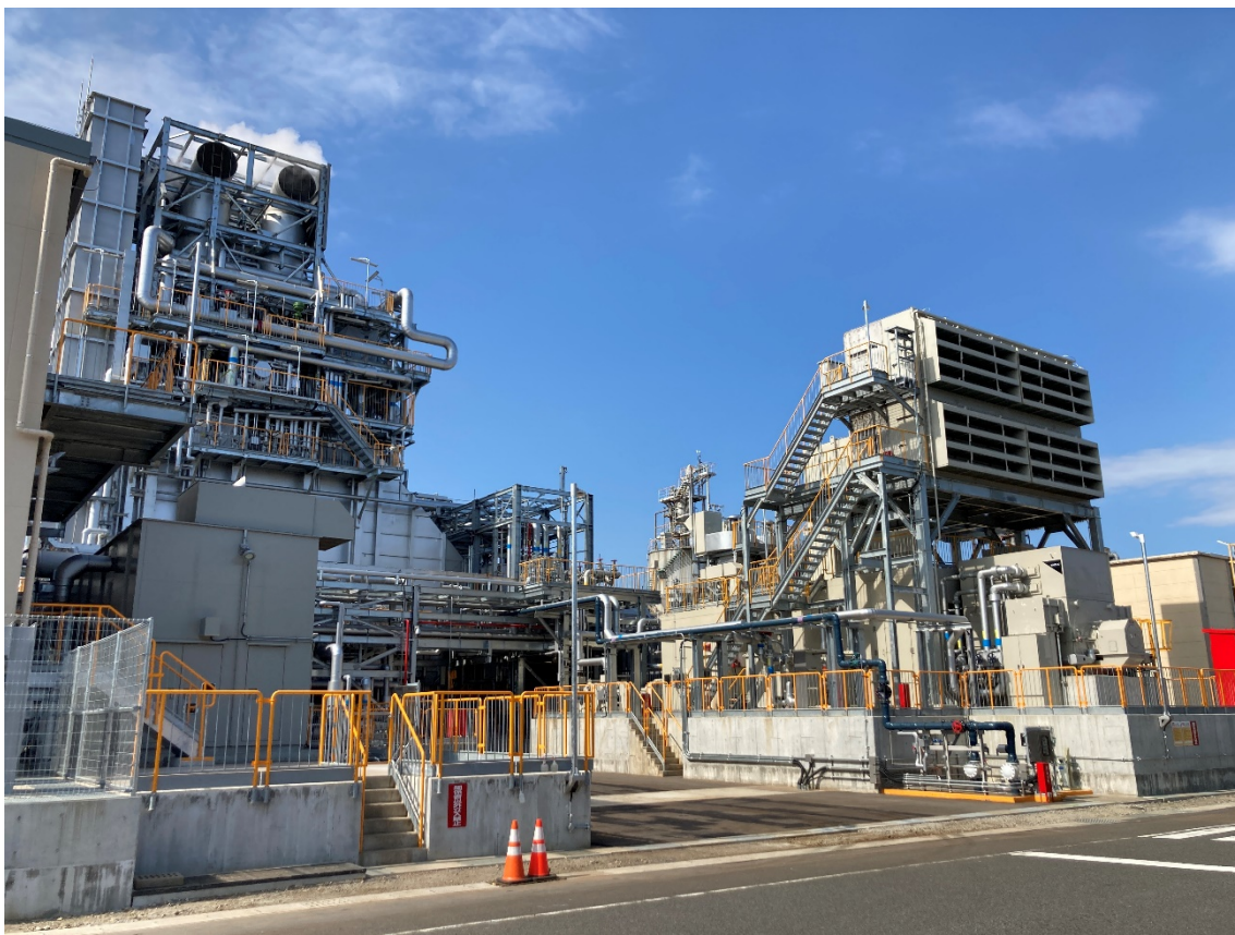
第3火力 ガスタービンコージェネレーション 外観
