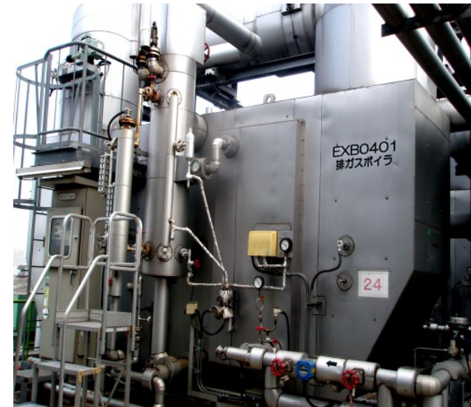
排ガスボイラ外観
