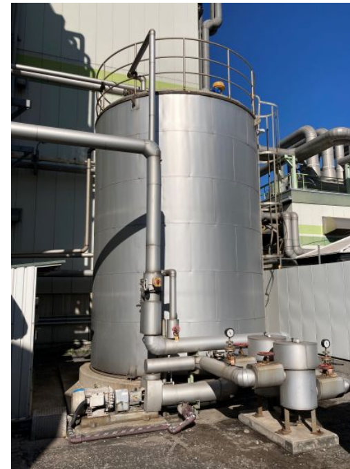
追設した温水供給設備
