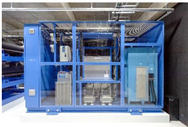
水素製造設備
