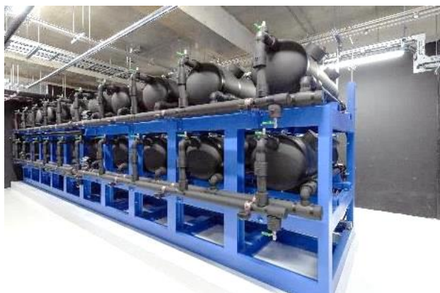
水素貯蔵設備
