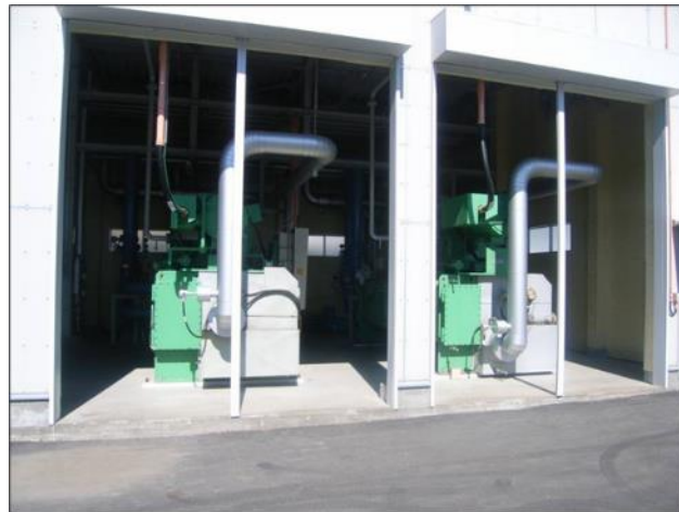
ターボ冷凍機 (1,628kW x 2基)
