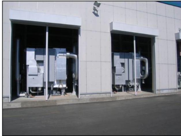
蒸気焚き吸収式冷凍機 (1,758kW x 2基)
