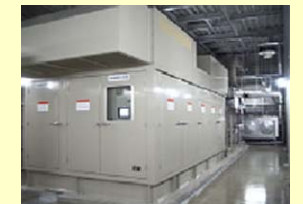
明治乳業旭川工場 GE(天然ガス;635kW)
