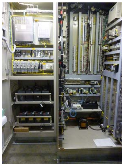
制御盤 (左下部はバッテリー)
