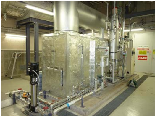
廃ガスボイラー
