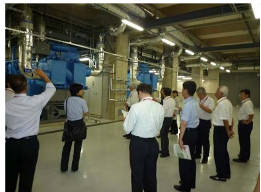
蒸気吸収冷凍機
