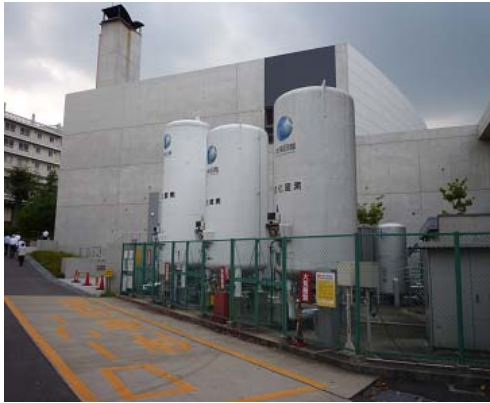
エネルギーセンター全景 1
