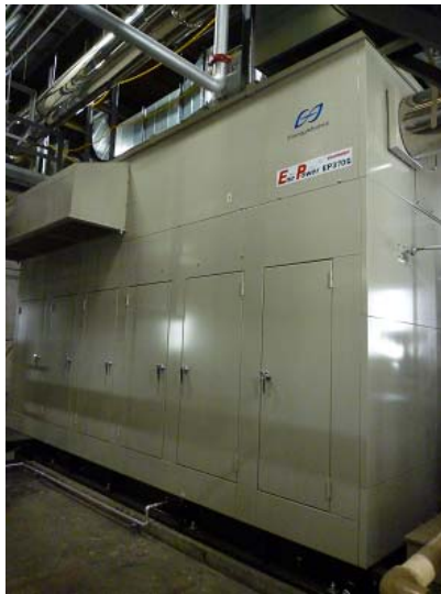
ガスエンジンコージェネレーション設備
