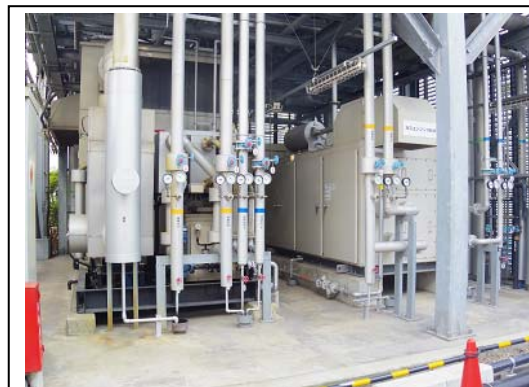
ガスエンジンコージェネ設備 (350kW,90kW)
