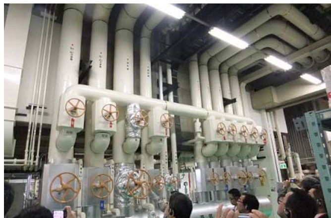
蒸気ヘッダー
