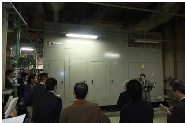
ガスエンジン CGS (370kW)
