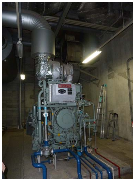
非常用発電機
