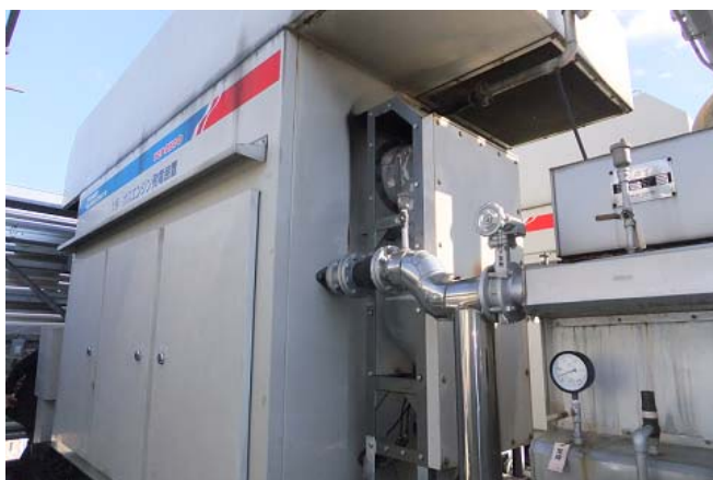
ガスエンジン CGS (200kW×2 台)
