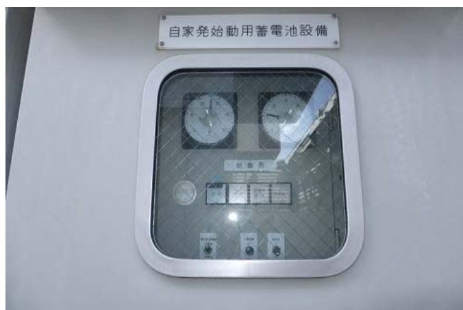
自家発始動用蓄電池設備
