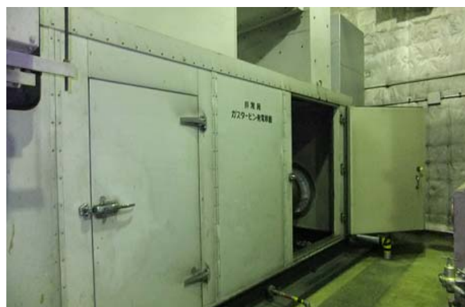
非常用ガスタービン発電機
