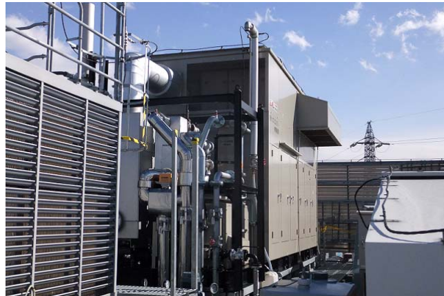
ガスエンジン CGS (370kW) <新規増設分>
