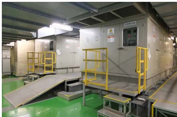
ガスエンジン CGS (930kW×2 台)
