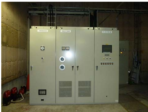
発電機盤（CGS 監視装置）
