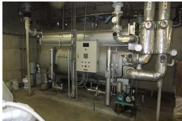
冷温水発生器（排熱利用）
