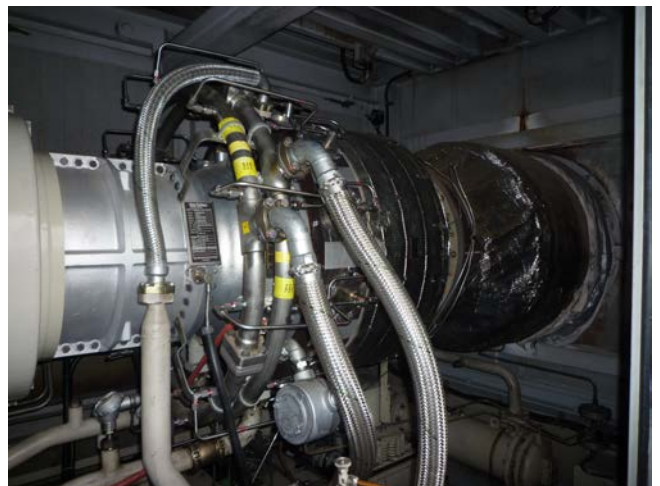
燃焼器（希薄予混合）及びパワータービン
