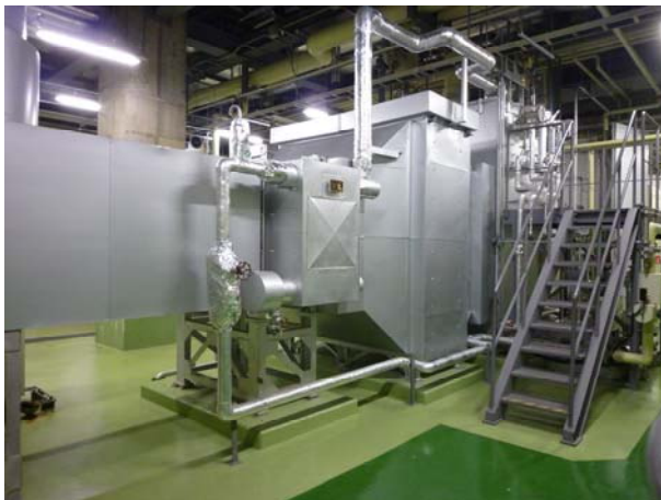
2,000kW ガスタービン用排熱ボイラ
