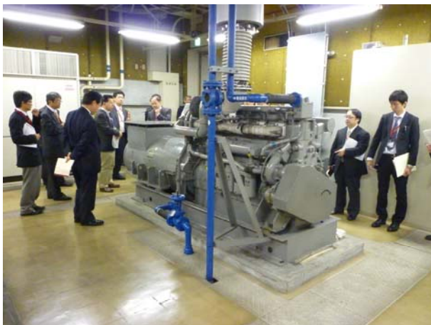
非常用発電機
