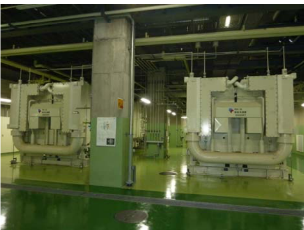
蒸気吸収式冷凍機
