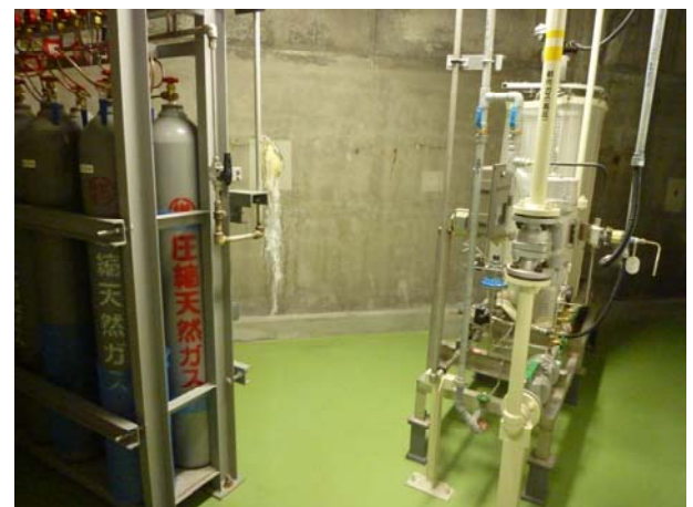
非常時起動用天然ガス圧縮ポンベ (2,000kW用)
