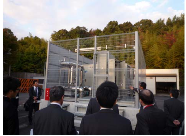
ガスエンジンコージェネレーション (35kW×6台)
