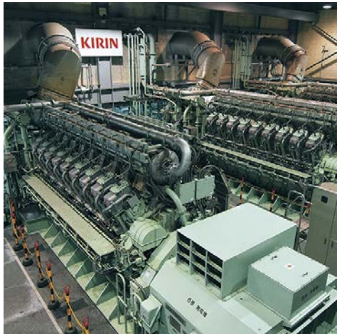
ガスエンジン発電機
