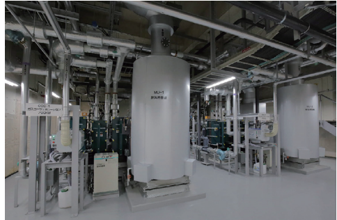
更新後のコージェネ発電機室
