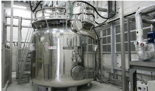
図-4 超伝導電力貯蔵装置
