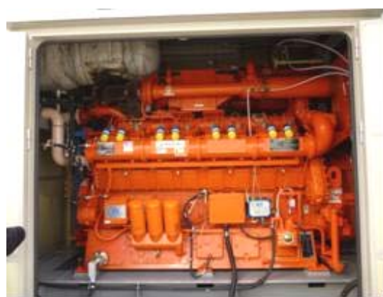
図 - 7 CGS 筐体内部
