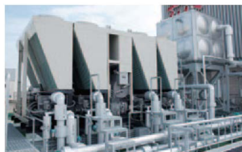
写真-2 高効率ターボヒートポンプ
