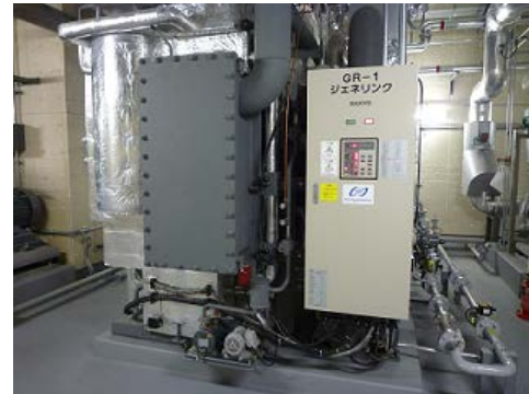
図-6 廃熱投入型ガス吸収冷温水機 300RT × 2
