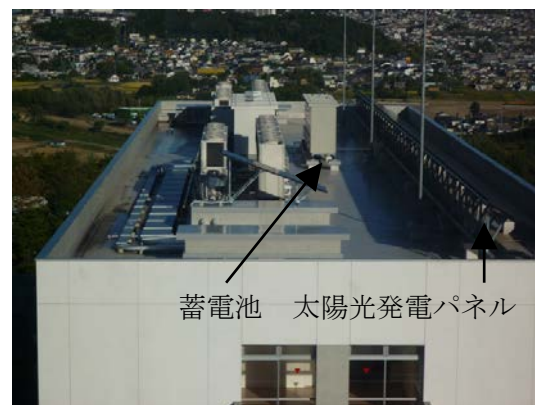
図-4 太陽光パネルおよび蓄電池外観
