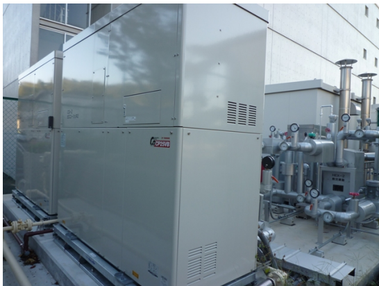
図-3 CGS (25kW×2台) 外観
