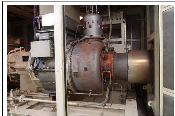
写真3. ガスタービン本体
