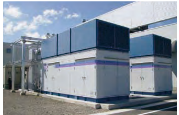
ガスエンジンCGS
