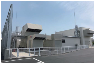
自己託送発電設備
