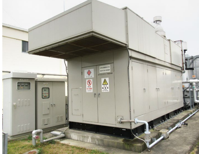
ガスエンジン・コージェネ(700kW)
