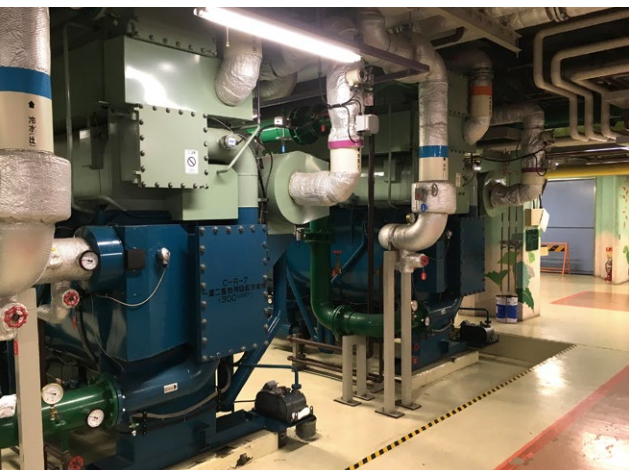
一重二重効用吸収式冷凍機
