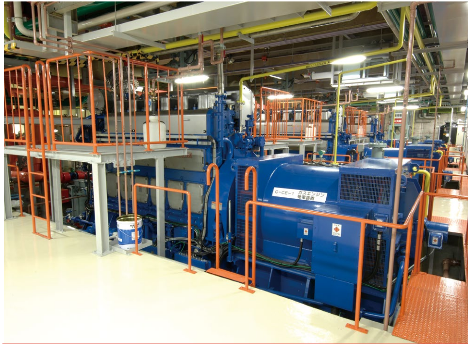
ガスエンジンコージェネ(1,500kW×3台)
