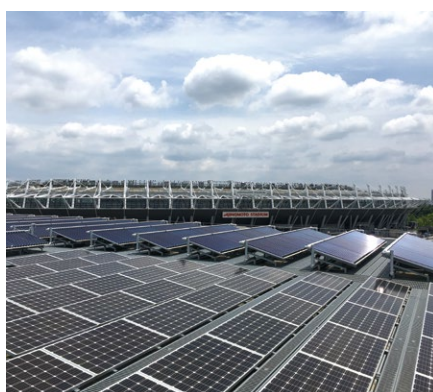
太陽光発電パネル(手前)と太陽熱集熱器(奥)
