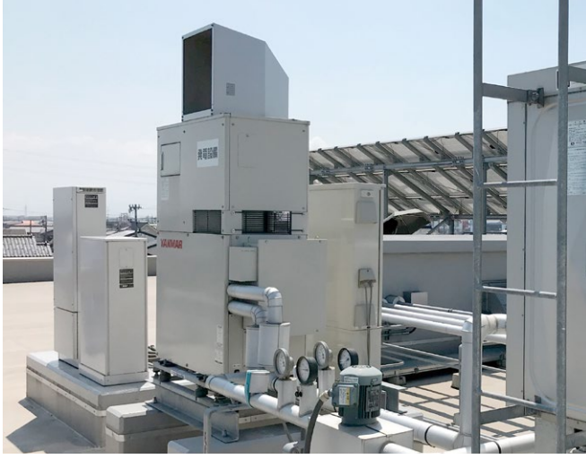
ガスエンジン・コージェネ(公民館屋上:5kW×1台)
