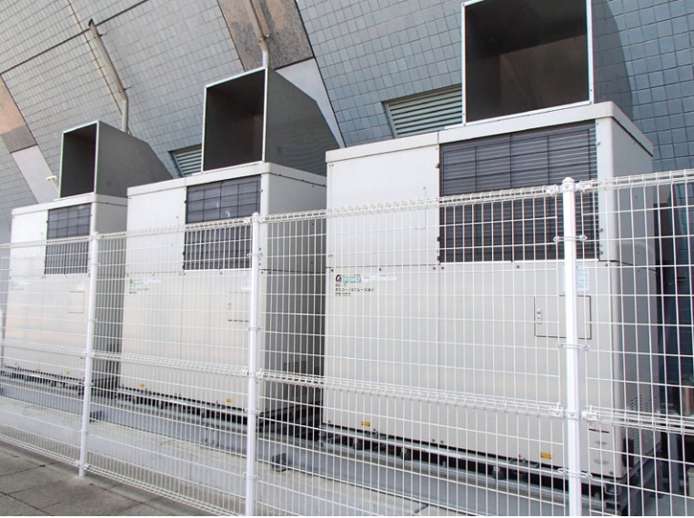
ガスエンジン・コージェネ (35kW×3台)
