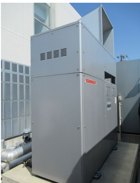
ガスエンジン・コージェネ(35kW×2台)
