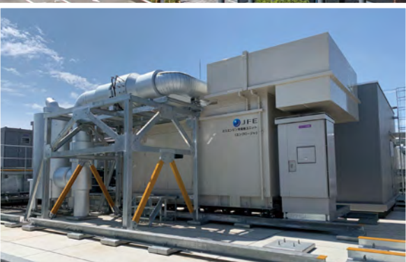
ガスエンジン・コージェネ(1,000kW×1台)
