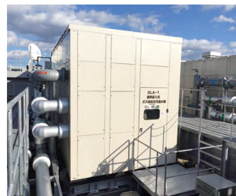
排熱投入式ガス吸収式冷温水機(2台)
