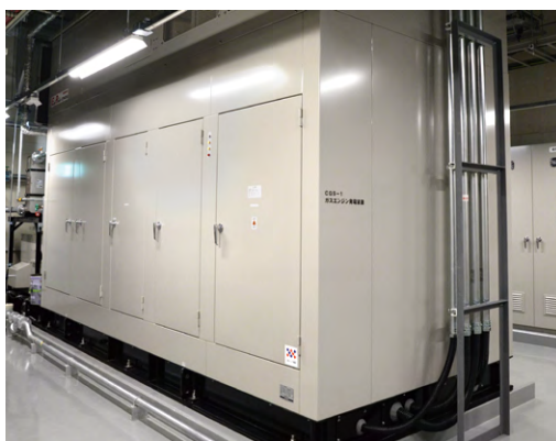
ガスエンジン・コージェネ(400kW×1台)
