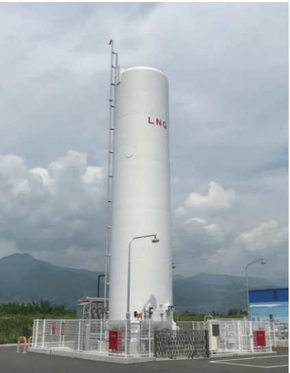
【LNGサテライト】
