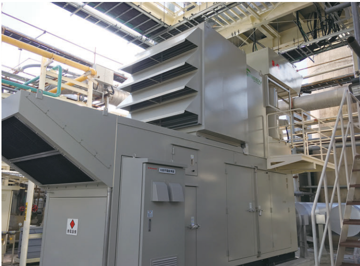
ガスタービンCGS外観
