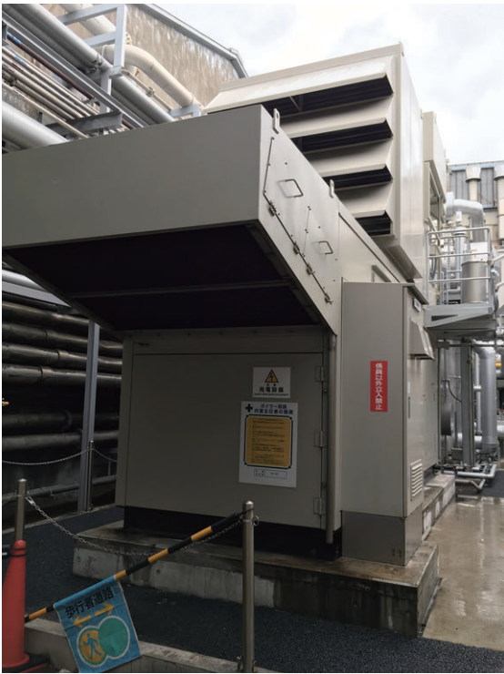
ガスタービンCGS外観
