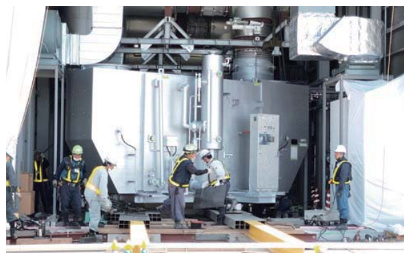
排熱回収ボイラ(3.1t/h×12台)～搬入時の様子～
