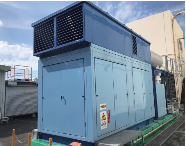
【コージェネ設置状況】
