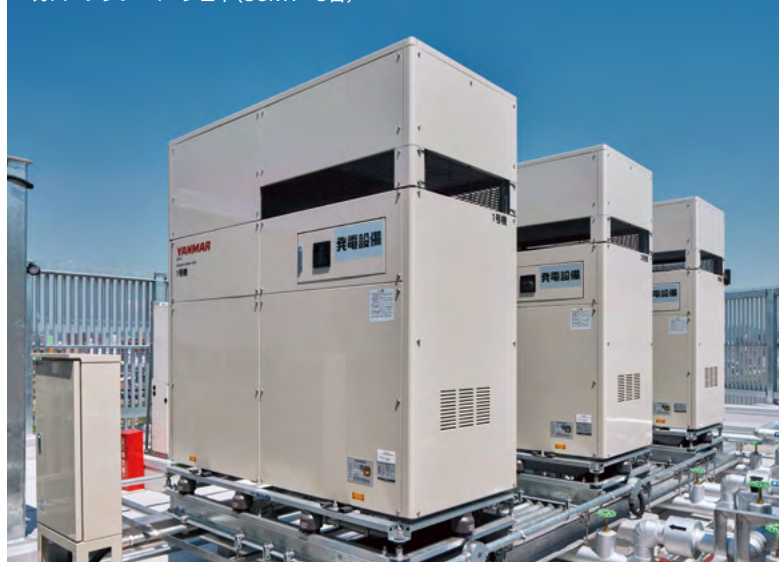
ガスエンジン・コージェネ(35kW×3台)
