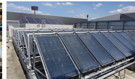
太陽光発電、太陽熱集熱パネル
