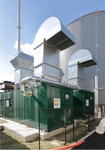
ガスエンジン・コージェネ(550kW×2基)
