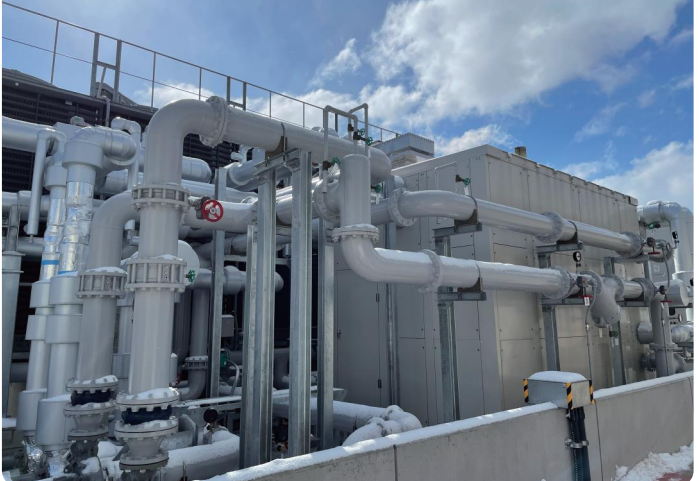
設備外観（ジェネリンク）
