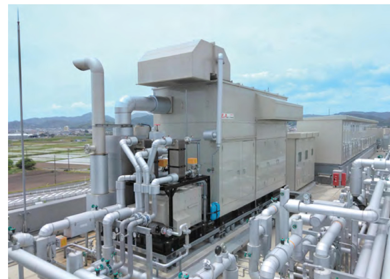
ガスエンジン・コージェネ(400kW)
