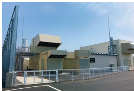
8MWのガスタービンと5MWのガスエンジンを備えた自己託送発電設備
