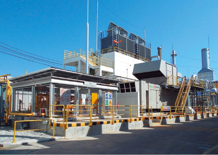
7MW級ガスタービンと高効率廃熱回収ボイラーを主要機器とするコージェネシステムを導入した
