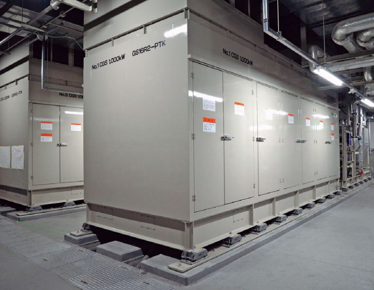
非常用発電機のほかガスコージェネ2台を導入、停電時にも電力供給可能に
