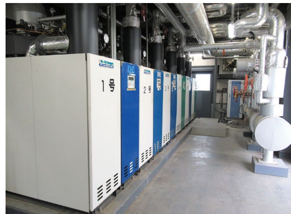
ボイラ棟内に設置された都市ガス焼き小型貫流式蒸気ボイラ（ 2.0\text{ t/h} \times 6\text{ 台} ）
