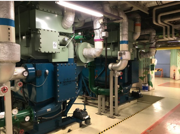
一重二重効用吸収式冷凍機
