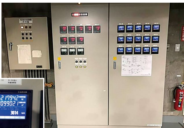
(左)動力盤面へのデジタル式熱量計の設置(下)デジタル式熱量計表示状況
