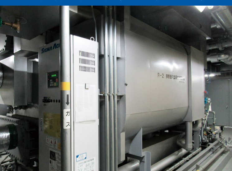
排熱投入型吸収冷温水機(400RT/1,407kW×1台)
