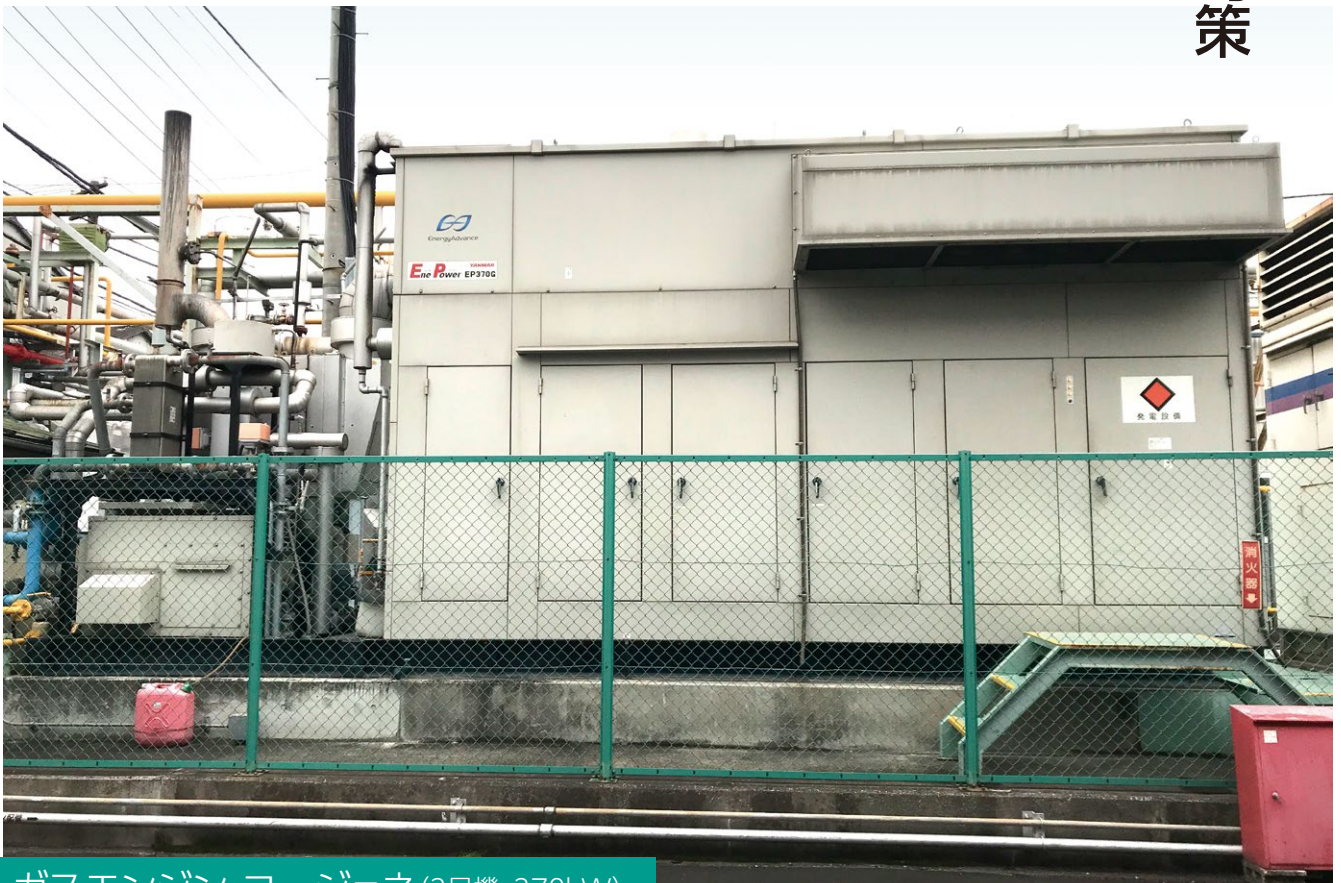
ガスエンジン・コージェネ(3号機、370kW)
