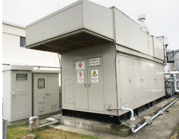
ガスエンジン・コージェネ(700kW)
