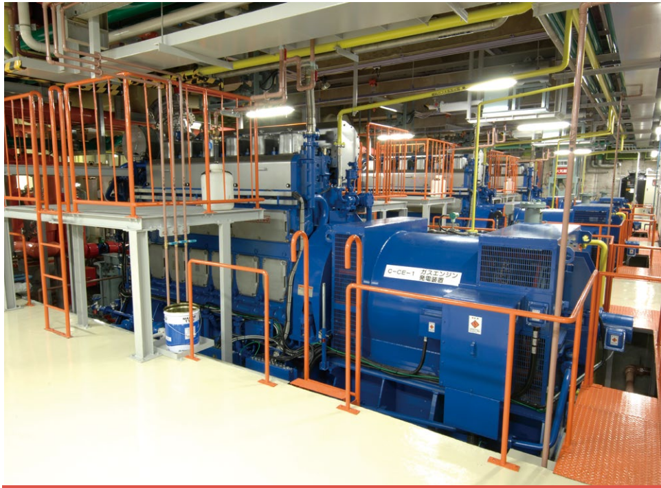
ガスエンジンコージェネ(1,500kW×3台)
