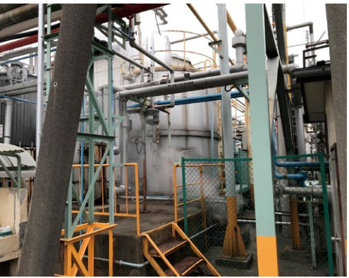
ボイラ給水タンク
