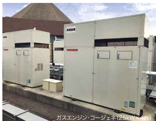
ガスエンジン・コージェネ(25kW×4台)
